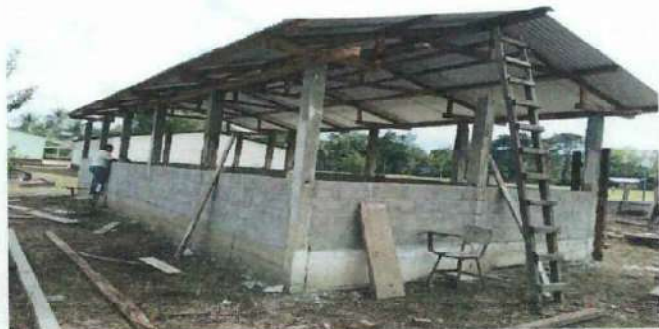
Foto 1: Falta de ventanas metálicas, falta de repello, piso y pintura.
