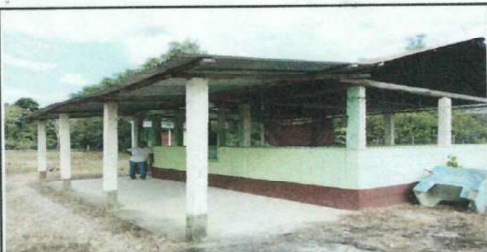
Foto 5: Deterioro de las vigas, costaneras y techo de la cocina escolar
