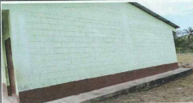
Foto 4: Deterioro de la estructura de pintura del edificio escolar.
