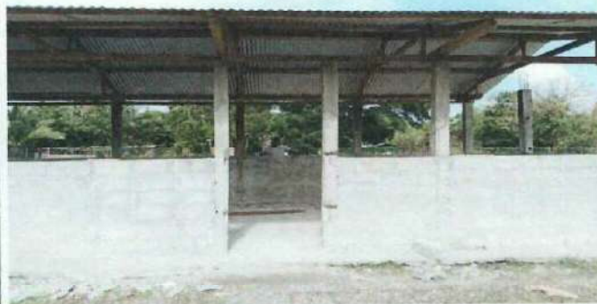
Foto 2: Falta de puerta metálica y chapa
