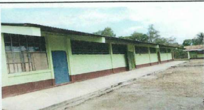
Foto 3: deterioro de la ventana de la escuela
