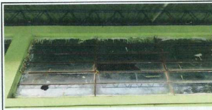
Foto 6: Deterioro de ventana de aula
